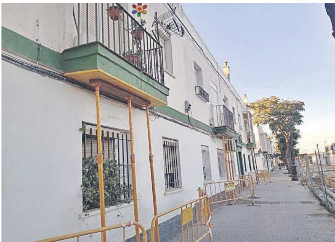
Uno de los balcones que ha tenido que ser apuntalado a causa de las obras.
